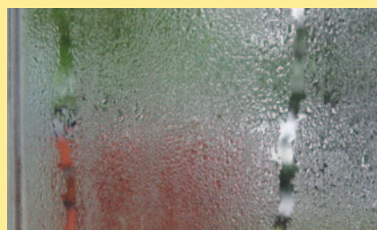
結露しているガラス窓
